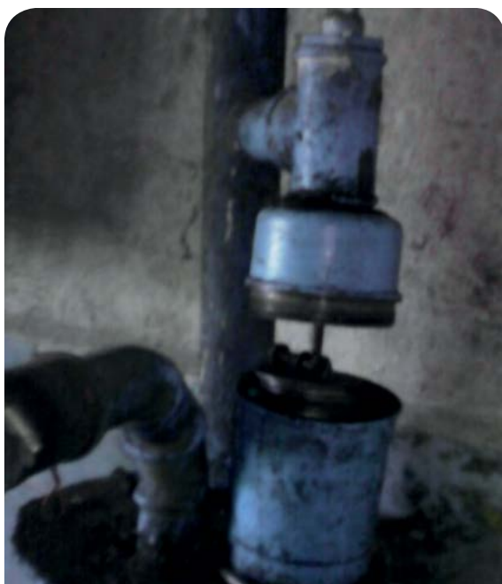
Рис. 1. Несправный вакуумный регулятор
