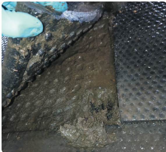
Рис. 12. Через швы под покрытие затекает вода и навоз
